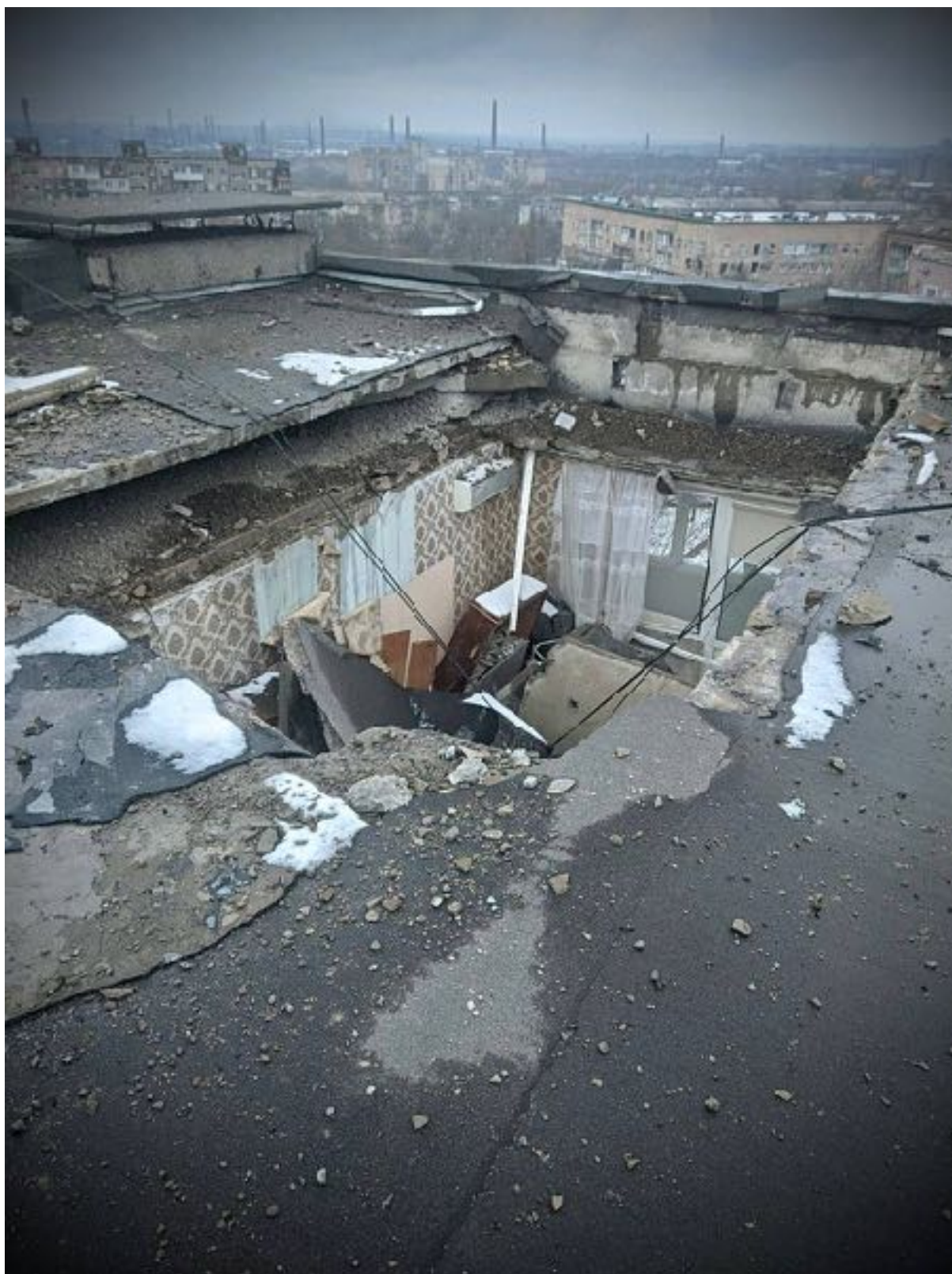
Pocisk trafił w dach domu Autor: Olya
